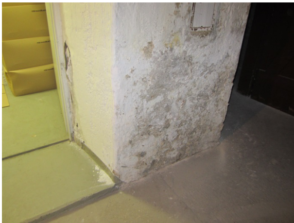
Bestandskeller mit feuchtem Mauerwerk und schadhaftem Putz.
