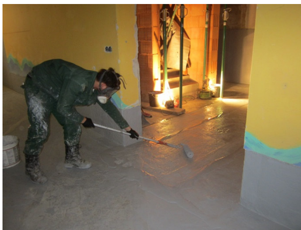
Aufbringen der Flüssigkunststoffabdichtung. Die Untergrundvorbereitung erfolgte durch Sandstrahlen zur Erreichung des erforderlichen Haftzugs.
