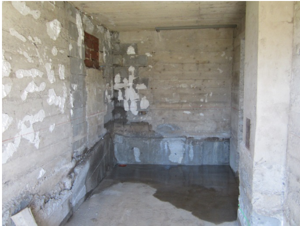
Bestandskeller mit starkem Wasserandrang über die eingeschütteten Außenwände.
