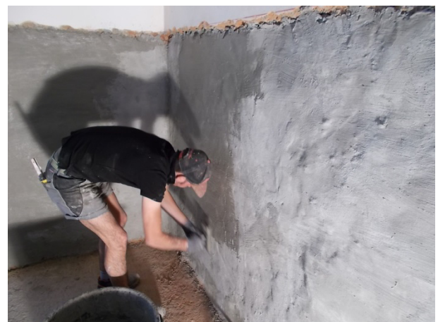
Aufbringen der silikatischen Dichtschlämme adicon SILAT nach Verdämmen des Mauerwerks und Durchführung der Horizontalsperren.
