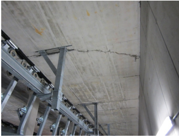
Rissbild mit Wassereintrittsstellen an der Deckenuntersicht in der „Sesselgarage“.
